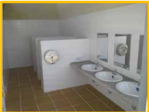
Baterías sanitarias para preescolar Institución Educativa de Santa Lucía – Atlántico.
